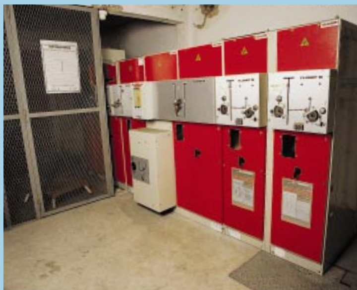
Tout commence au point de livraison du courant...
