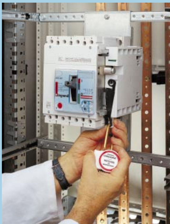
Condamnation d’un DPX 250 : le cadenas empêche toute manœuvre de fermeture ou de réembrochage
